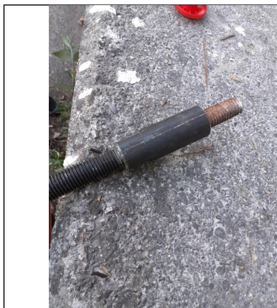
Rottura della barra nella zona filettata. Riduzione della sezione resistente
